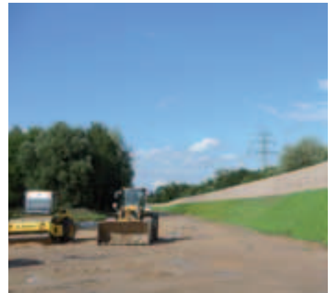
Lärmschutz an der Westumgehung.
